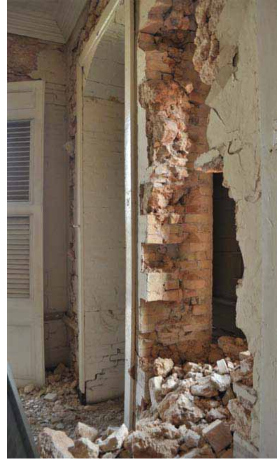
• 45-b : Vue intérieure de la Villa Castel Fleuri, montrant un pan de mur en moellons qui s'est totalement effondré entre les piliers en maçonnerie de briques. A remarquer les agrafes en briques qui s'étaient enfoncées dans les parois en moellons.
