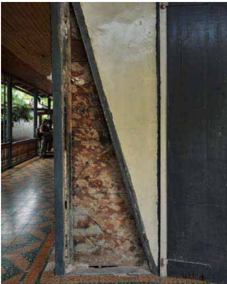
• 41 : Maison au 15 rue M montrant un hourdage de moellons. À gauche, une paroi s'est écroulée dans le tremblement de terre, révélant qu'elle avait été renforcée avec du fil de fer barbelé intégré en zigzag dans les entrevous.
