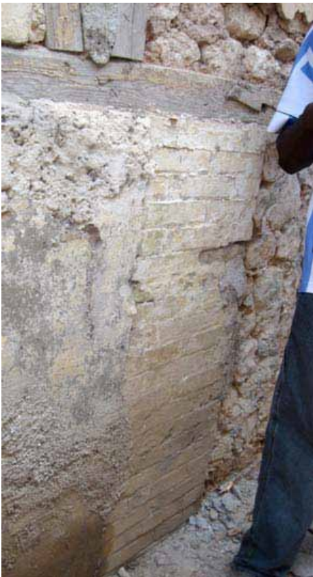
• 51 : Le pilier de soutènement original en maçonnerie de briques est visible avec son hourdage composé de stuc et de moellons. L'humidité provenant du sol a causé une détérioration considérable à la maçonnerie de moellons exposée. Ceci est le résultat de la migration de sels solubles à la surface où ils se dilatent en séchant, causant l'effritement de la couche de maçonnerie.
