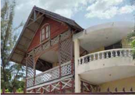
• 48 : Des ajouts en ciment sont souvent insolites ou compromettent l'architecture des bâtiments gingerbread comme cette maison au 51 de l'avenue Christophe.
