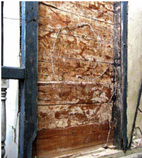
• 40 : Dans cette maison à colombage, le hourdage en moellons s'est effondré pendant le tremblement de terre, révélant le renforcement en fil de fer barbelé. Il s'agit là d'un exemple de matériaux mal adaptés à la construction utilisés à cause de leur disponibilité apparente. Le fil de fer barbelé était galvanisé et est encore en bon état.
