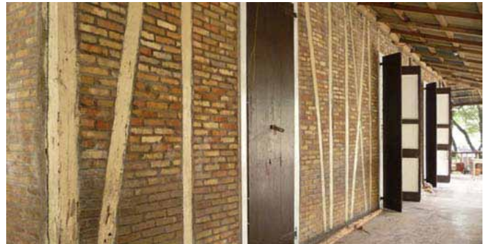
• 38 : Colombage avec hourdage briques et de torchis de chaux au 30 de l'avenue Lamartinière.
