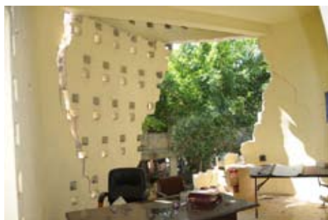
Vues du local de l'ISPAN après le séisme
