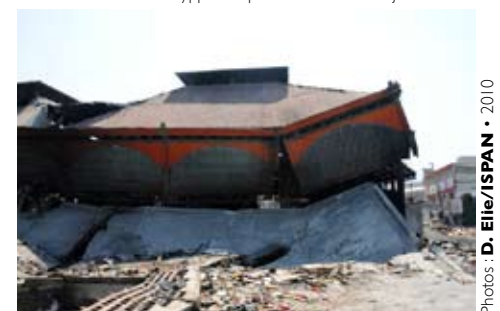
• Vue de la halle sud endommagée lors du séisme
